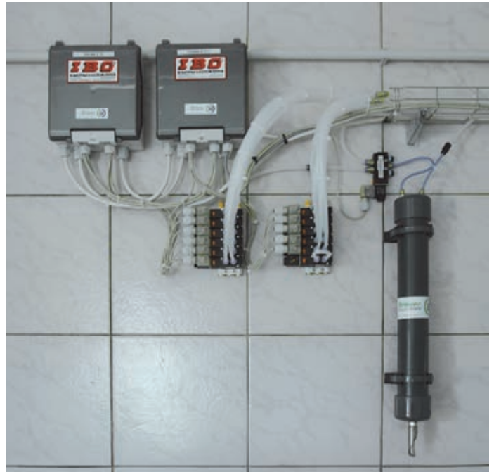
ZENTRALSTEUERUNG MIT ENTWÄSSUNGSVENTIL
