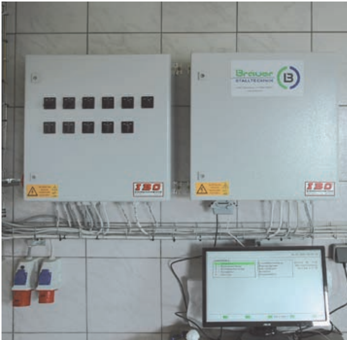
VOLLAUTOMATISCH GESTEUERTE CCM-TROCKENFÜTTERUNGSANLAGE mit Sensorüberwachung inkl. Schalt- und Steuerschrank, komplett vorverdrahtet
