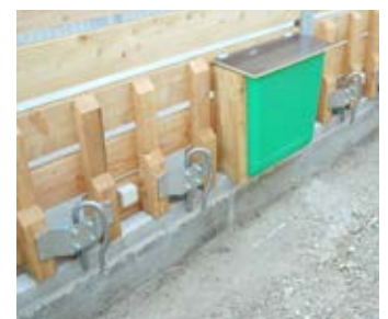
Auslauf-Ringleitung für das Trinkwasser Außenwand-Seite
