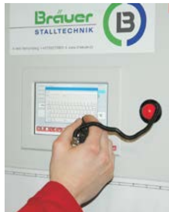
Touchbedienung direkt am Schaltschrank
